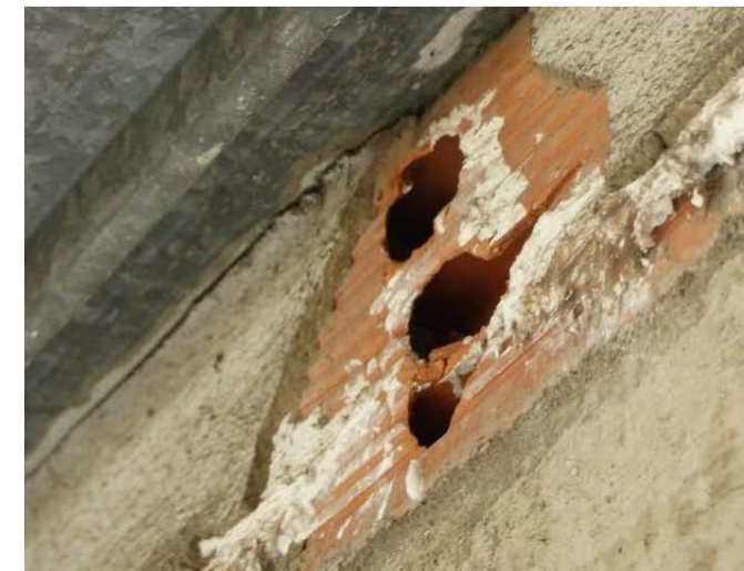
Figure 14 : Brique creuse d'un des bâtiments situés sur les toitures au sein du campus Santé susceptible d'abriter des chiroptères
